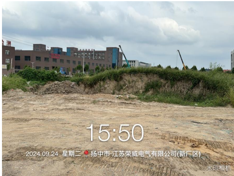
镇江三安电气项目对面地块：大量裸土未覆盖到位， 地面未洒水降尘，现场积尘严重。
