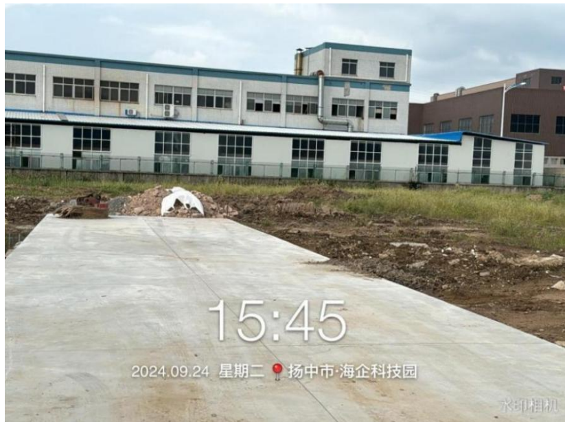
镇江三安电气项目施工地块：大量裸土未覆盖到位，地面未洒水降尘，现场积尘严重。
