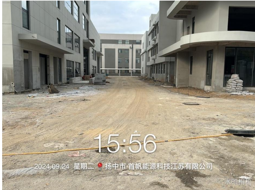
首帆能源科技有限公司：大量裸土未覆盖到位， 地面未洒水降尘，现场积尘严重。
