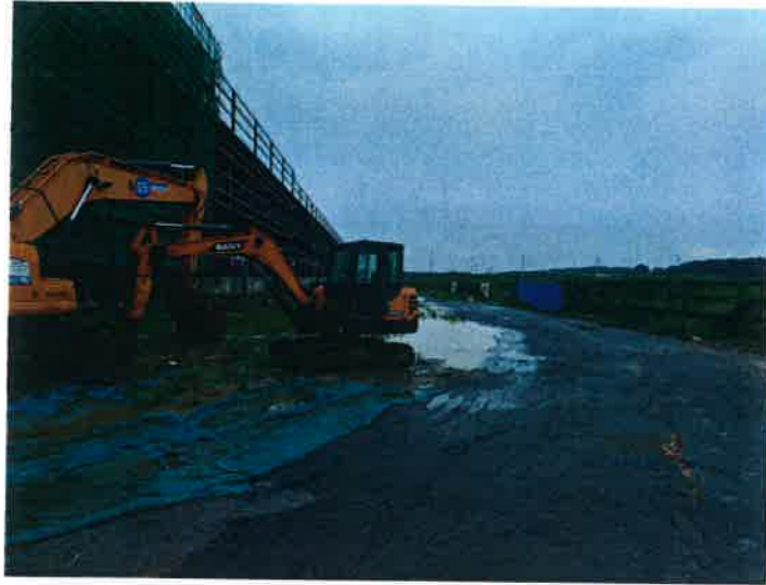
整改：裸土覆盖
