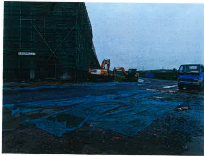
整改：裸土覆盖
