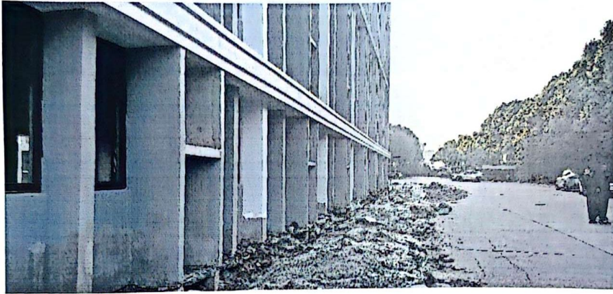
整改前：部分裸土未覆盖
